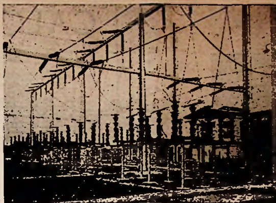
Afb. 3. Het openlucht-transformatorstation van de N.V. Provinciaal en Gemeentelijk Utrechts Stroomleveringsbedrijf te Utrecht. Aandacht verdient de eenvoud van opzet en de consequente doorvoering van de bliksemraden.
